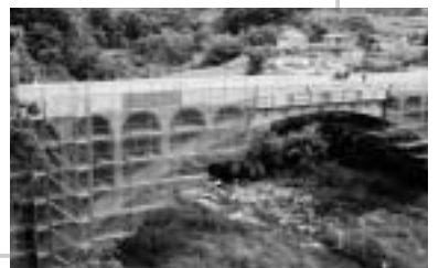
峡東地域広域水道事業団が建設している琴川ダムの水道水の本管が日川を渡る水道橋となる。今年10月に完成予定
